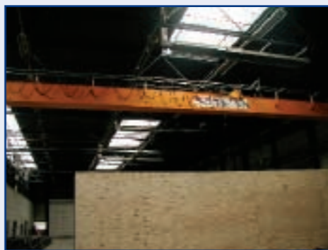
Bovenloopkraan/Overhead Crane KONE, 5 ton, overspanning ca. 21 m.
